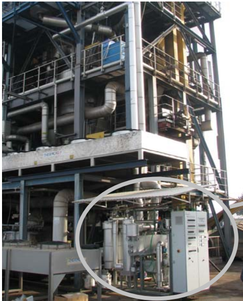
Abbildung 5: Versuchsanlage (grau markiert) vor Biomasse-Kraftwerk in Güssing, Österreich.
